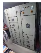
ควบคุมระบบไฟฟ้าประจำอาคาร
