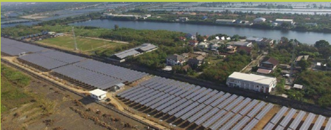
รูปที่ 5 แผงโซลาร์เซลล์ โรงงานผลิตไฟฟ้าพลังงานแสงอาทิตย์ที่บริเวณนาเกลือโคกขาม (ปัจจุบันรื้อถอนออกไปหมดแล้ว) ที่มาภาพ Facebook page: Power plant thailand
