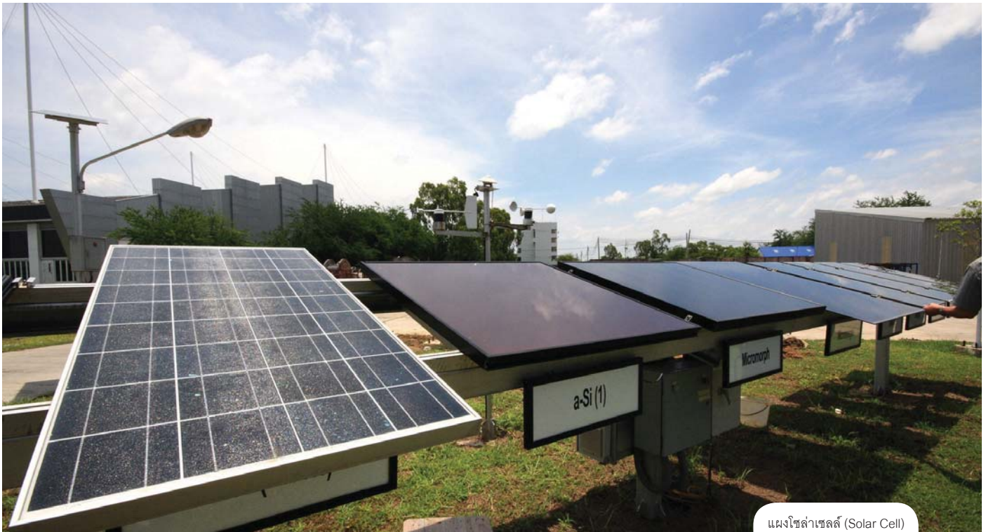
แผงโซลาร์เซลล์ (Solar Cell)
