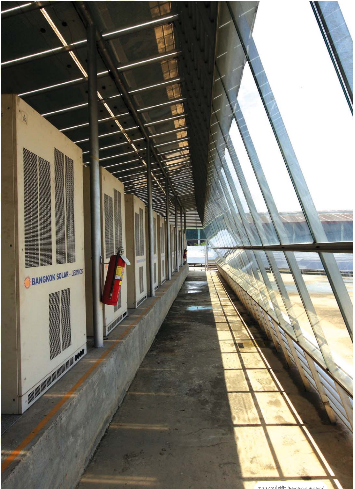
ระบบงานไฟฟ้า (Electrical System)
