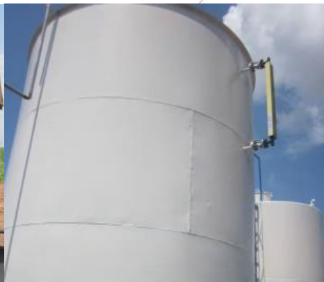
ถังเก็บน้ำมัน
