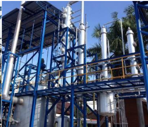
ระบบ condenser, oil/water separator
