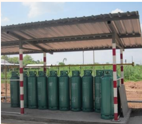
Gas station สำหรับ Preheating ระบบ
