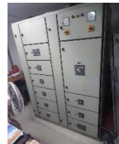
ควบคุมระบบไฟฟ้าประจำอาคาร
