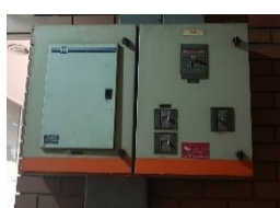
ควบคุมระบบไฟฟ้าประจำชั้น
